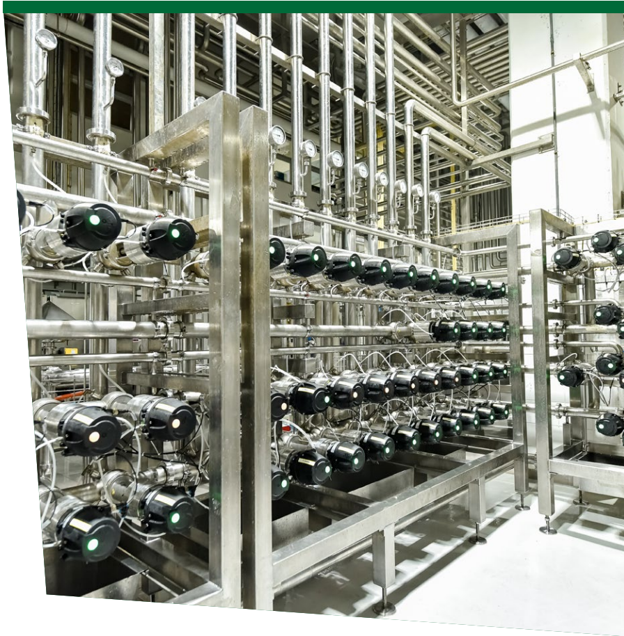
*Automatización de la Sala de Filtración.
